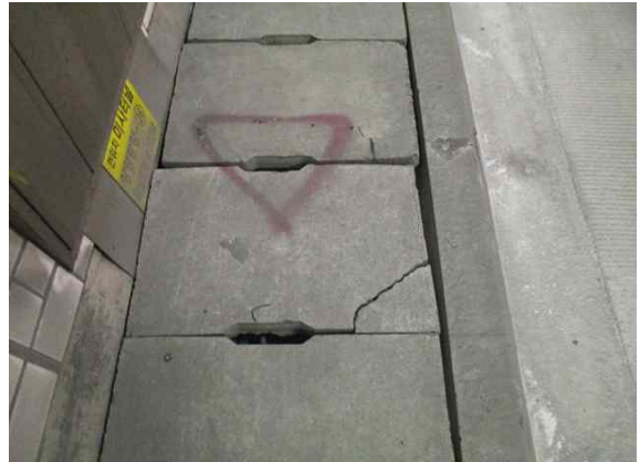
공동구 SPAN.114 덮개 파손
