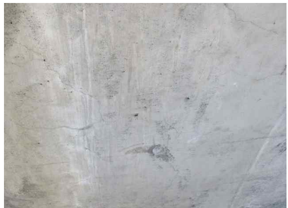
라이닝 SPAN.244 망상균열
