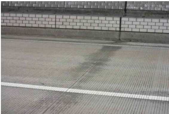
포장부 SPAN.69 누수흔적
