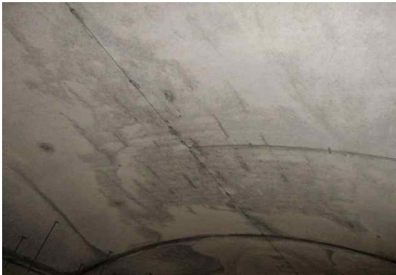
라이닝 SPAN.74 와이어매쉬 노출
