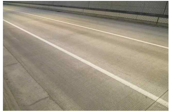
포장부 SPAN.22 균열(0.3mm 이상)
