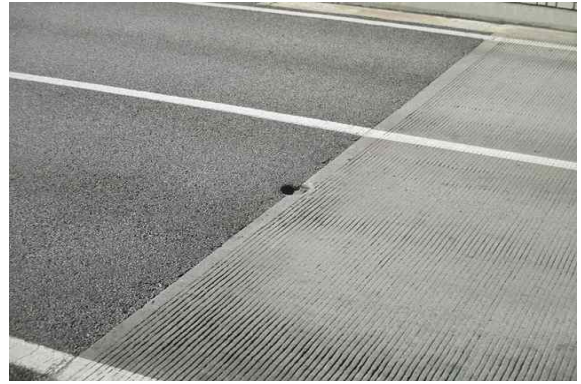
포장부 SPAN.1 포트홀
