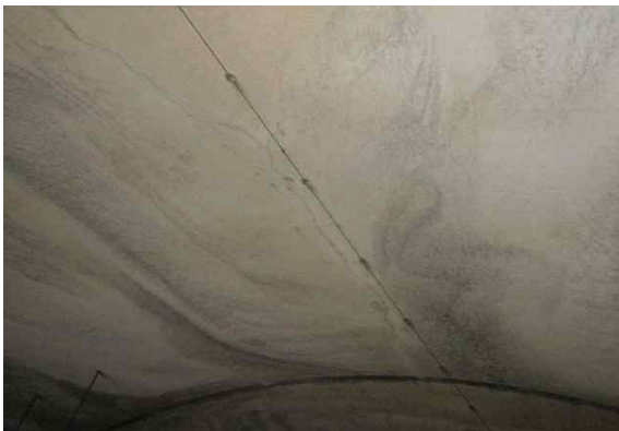
라이닝 SPAN.121 균열(0.3mm 이상)
