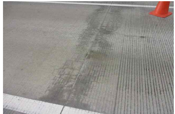
포장부 SPAN.70 누수흔적
