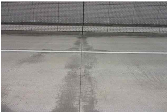
포장부 SPAN.71 누수흔적
