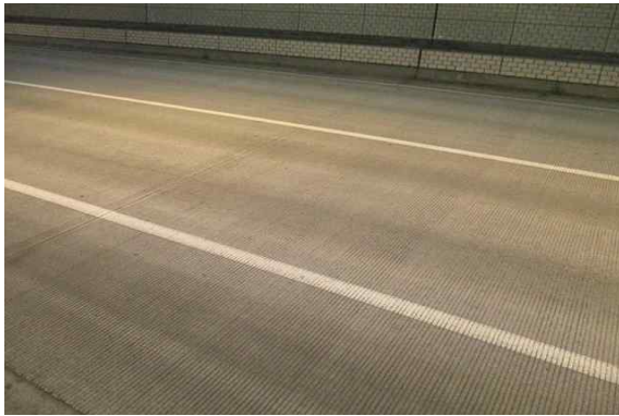
포장부 SPAN.18 균열(0.3mm 이상)
