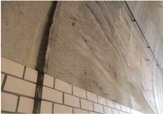
라이닝 SPAN.4 재료분리
