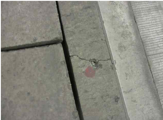
공동구 SPAN.133 균열(0.3mm 이상)
