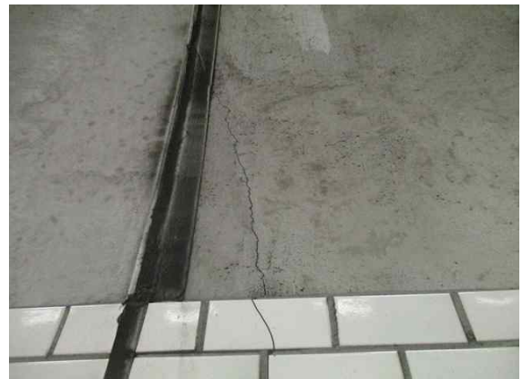
측벽부 SPAN.50 균열(0.3mm 이상)
