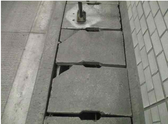
공동구 SPAN.54 덮개 파손
