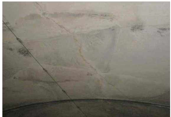
라이닝 SPAN.147 균열(0.3mm 이상)
