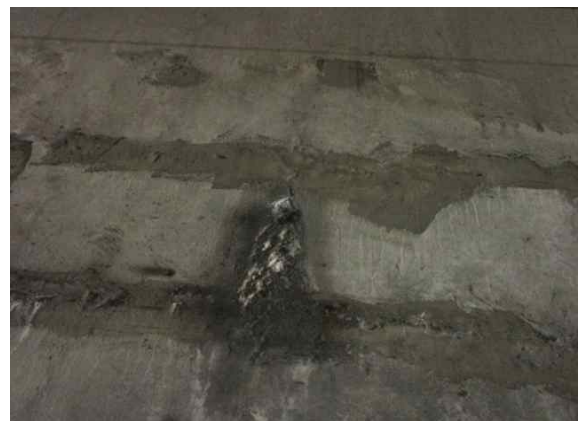
측벽부 SPAN.187 누수흔적
