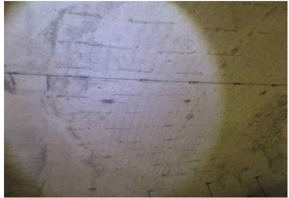
라이닝 SPAN.68 와이어매쉬 노출
