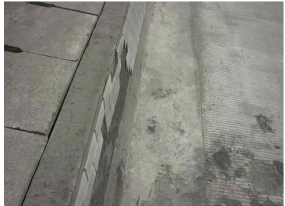
공동구 SPAN.161 타일 탈락
