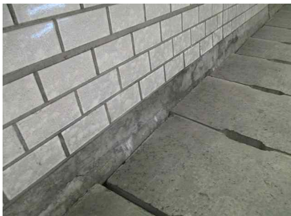
측벽부 SPAN.72 백태
