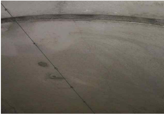
라이닝 SPAN.48 균열(0.3mm 이상)
