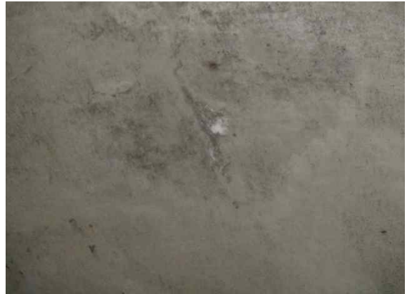
라이닝 SPAN.189 백태
