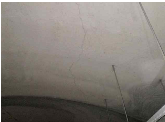
라이닝 SPAN.228 균열(0.3mm 이상)
