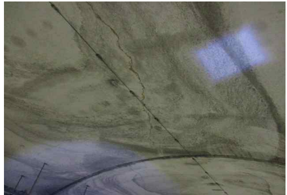
라이닝 SPAN.95 균열(0.3mm 이상)
