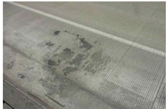
포장부 SPAN.161 파손
