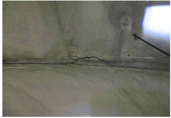
라이닝 SPAN.19 조인트부 들뜸
