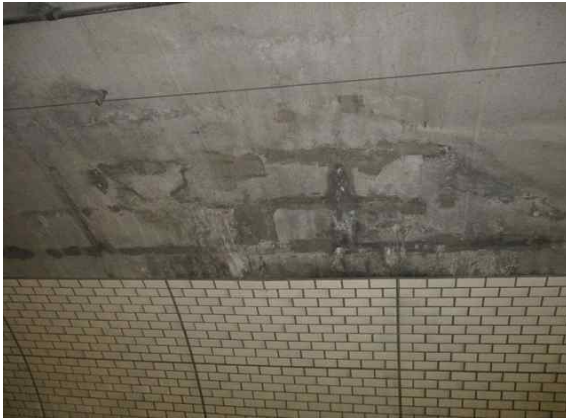
라이닝 SPAN.187 백태
